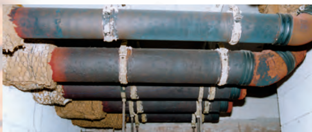
Après l'essai incendie
